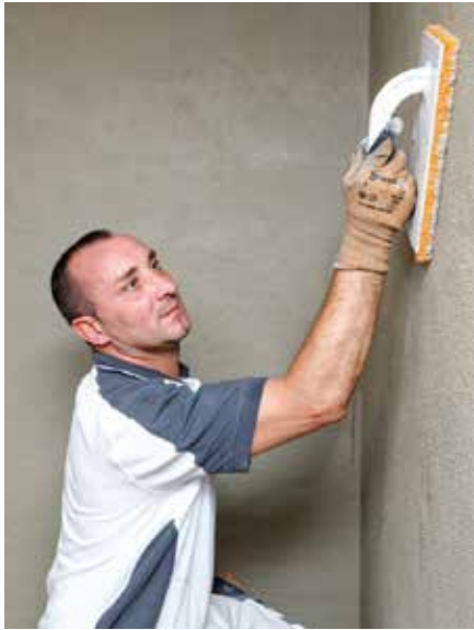
Eine fachgerechte Sanierung eines feuchten Kellers schafft trockene Räume und zusätzlichen Stauraum. (Foto: ISOTEC)
